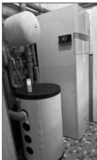
Nachher (November 2024) Die Wärmepumpenheizung (Innen) steht in der gleichen kleinen Ecke, in der zuvor die Gasheizung stand.
